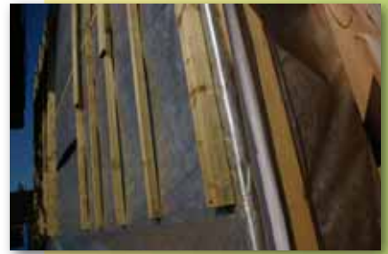
La maison est recouverte d'une membrane pour éviter les pertes de chaleur.
