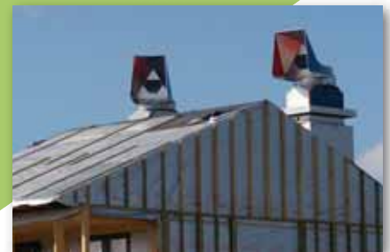
Ventiler sans électricité
