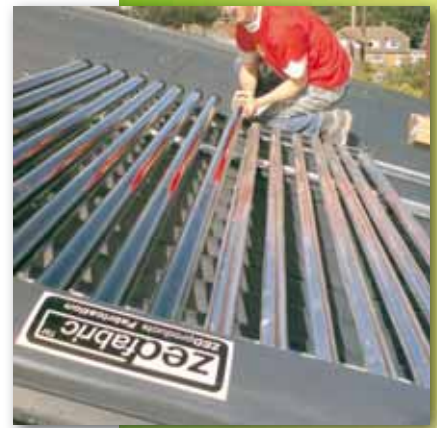
L'eau est principalement chauffée par l'énergie solaire
